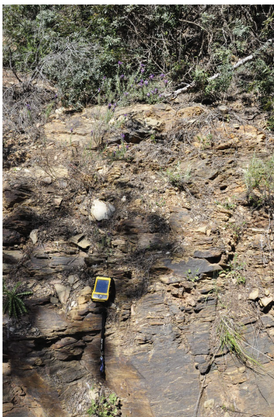
Figura 28 – Fotografia V376 . Esiguo spessore della coltre di alterazione superficiale e giacitura a reggipoggio delle discontinuità della roccia costituente il substrato
