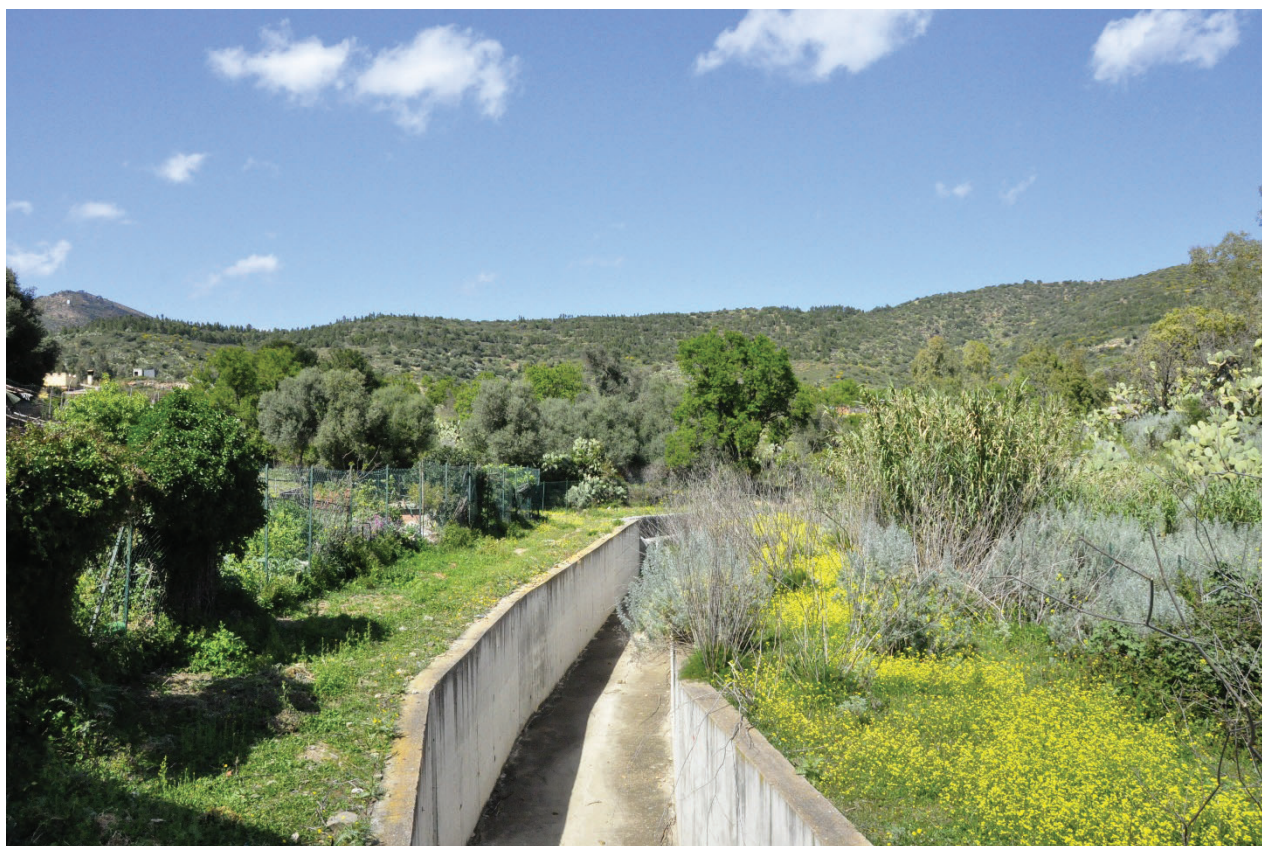
Figura 14 – Fotografia V410 . Opera idraulica di regimazione delle acque connessa con il canale tombato posto al di sotto della Via La Marmora
