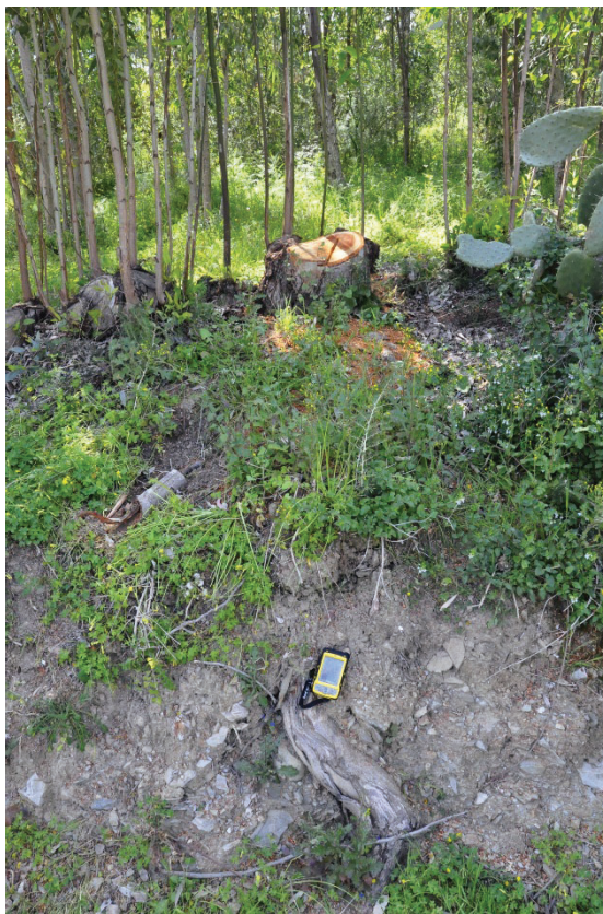
Figura 7 - Fotografia V411 . Taglio stradale che mostra la presenza di detriti superficiali stabilizzati dalla vegetazione
